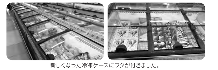
新しくなった冷凍ケースにフタが付きました。
